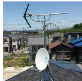
屋根上設置アンテナ
